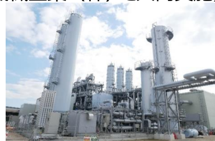
LAES商用実証プラント (廿日市工場内)
