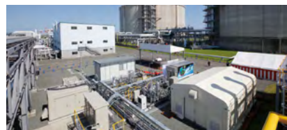
メタネーション実証設備
