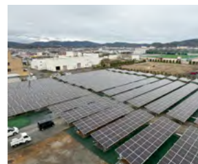
東尾道太陽光発電所
