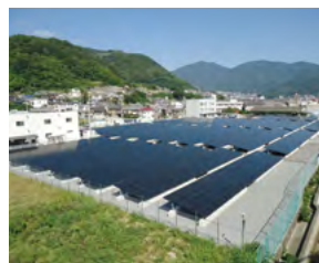
阿賀太陽光発電所
