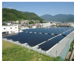
阿賀太陽光発電所
