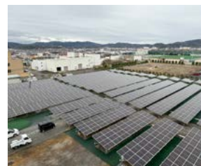
東尾道太陽光発電所
