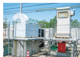
ガス差圧発電装置
