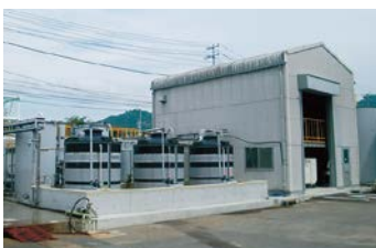
水処理装置(海田基地)
