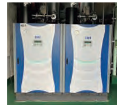
燃料転換したボイラ
