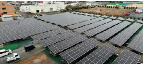
東尾道太陽光発電所
