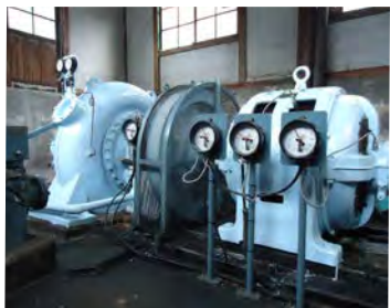
水車および発電機
