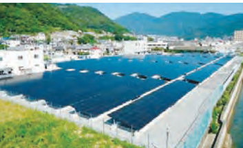
阿賀太陽光発電所
