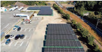
備後工場太陽光発電設備
