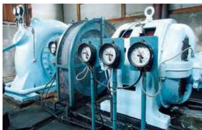
広島ガス志和堀発電所(水車および発電機)
