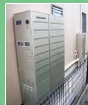
厨房・給湯など
