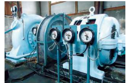
水車および発電機
