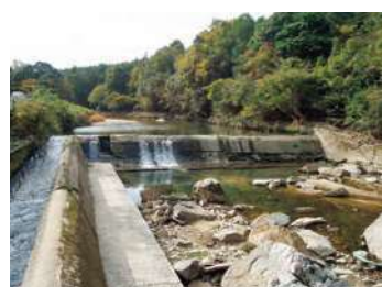
小水力発電 取水堰および導水路(東広島市志和町)
