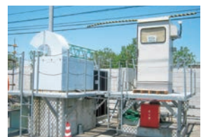
ガス圧差発電装置
