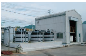
水処理装置（海田基地）
