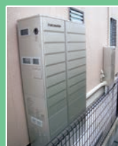
厨房・給湯など
