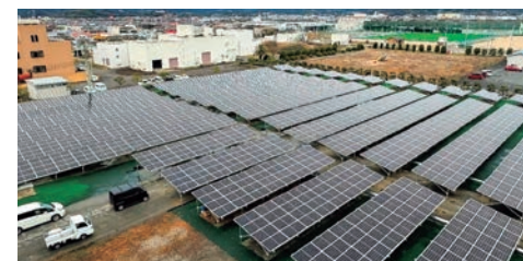
東尾道太陽光発電所
