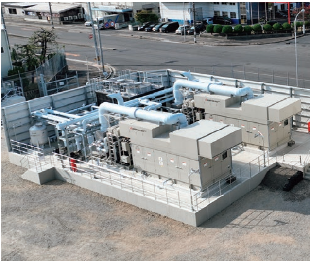
新設したガスコージェネレーションシステム
