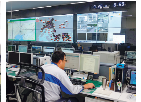
都市ガスの供給状態を24時間監視する保安指令センター
