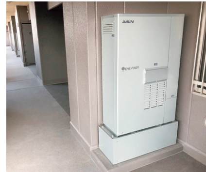
集合住宅に設置されたエネファーム
