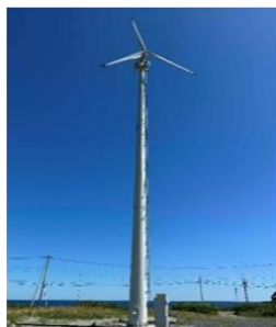
小形風車の外観（宗谷郡猿払村）
