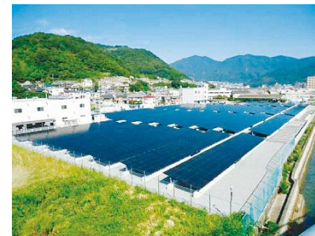
阿賀太陽光発電所(呉市)
