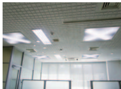
LED照明(本社ビル1Fロビー)
