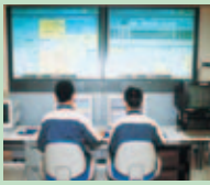
中央監視制御室(本社)
