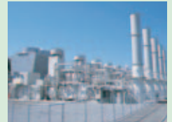
ガスコージェネレーションシステム、加熱、空調等
