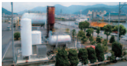
LPGタンカー窒素パージプラント
