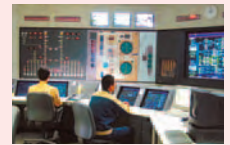
中央制御室での一括監視（廿日市工場）
