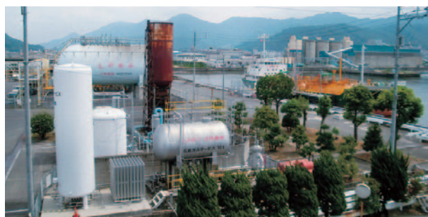
LPGタンカー窒素パージプラント
