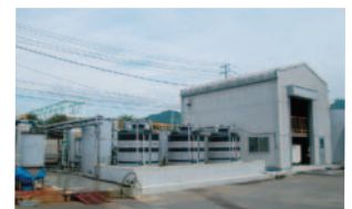
水処理装置(旧海田工場跡地)
