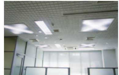
LED照明(本社ビル1Fロビー)
