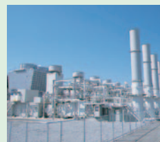
ガスコージェネレーションシステム、加熱、空調等
