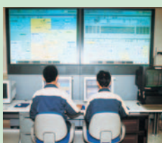
中央監視制御室(本社)
