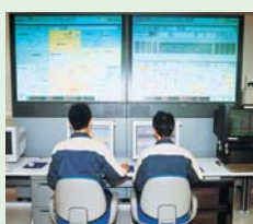
中央監視制御室（本社）
