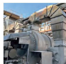
燃料転換した乾燥炉
