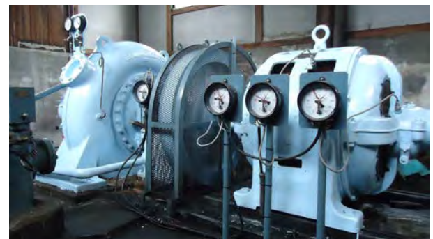
水車および発電機
