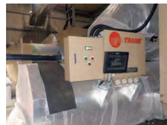
(株)やまみ高効率冷凍機
