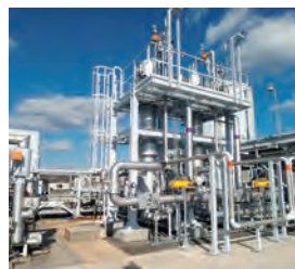
備後工場LNG気化器
