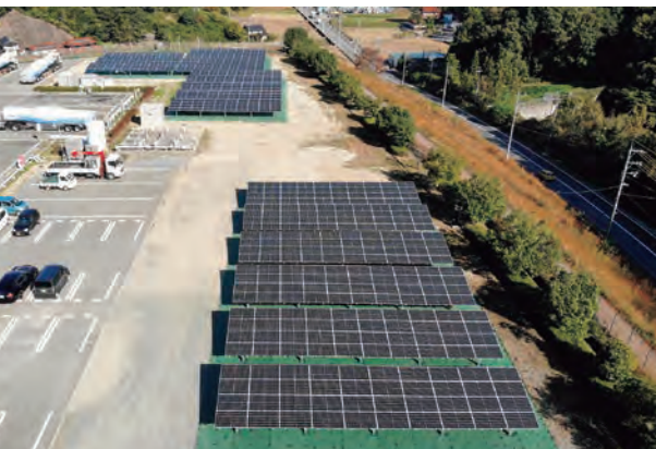
備後工場太陽光発電設備
