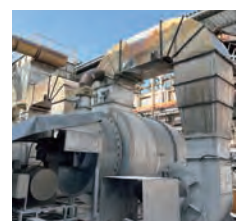
燃料転換した乾燥炉
