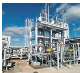
備後工場LNG気化器
