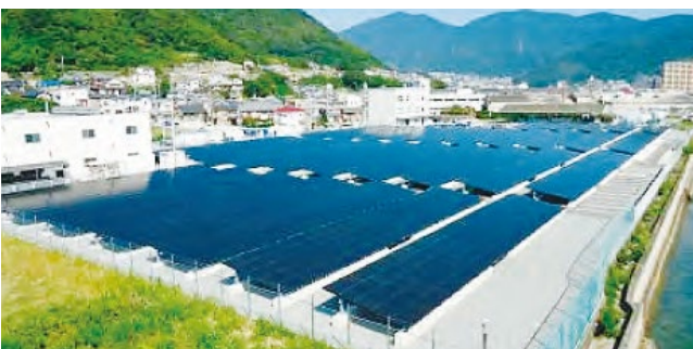
阿賀太陽光発電所
