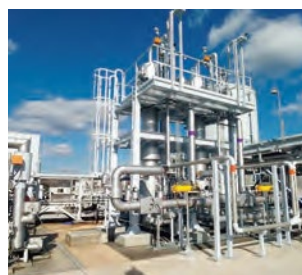
備後工場LNG気化器
