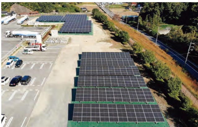
備後工場太陽光発電設備
