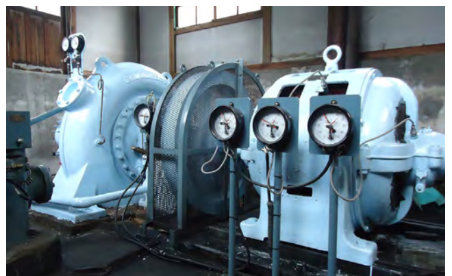
水車および発電機
