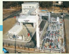
水島ステーション (瀬戸内パイプライン(株))
