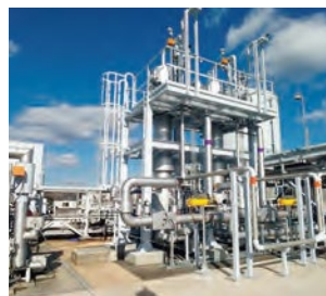
備後工場LNG気化器
