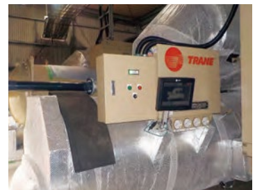
(株)やまみ高効率冷凍機
