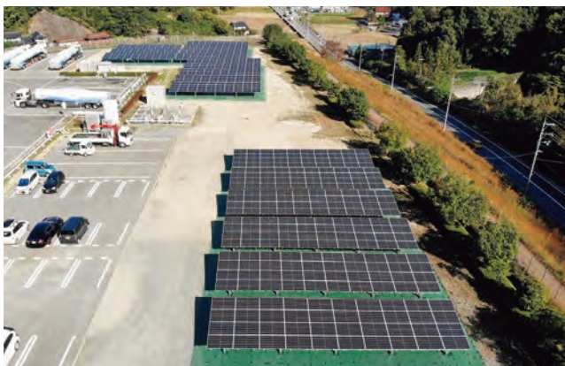
備後工場太陽光発電設備
