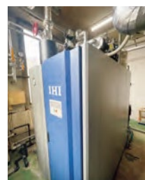
燃料転換した蒸気ボイラ
