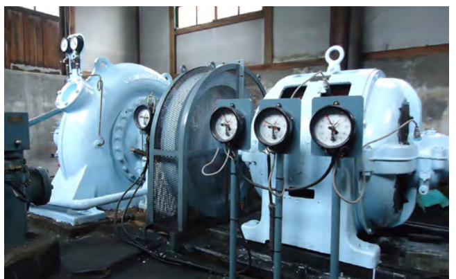
水車および発電機
