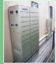
厨房・給湯など
