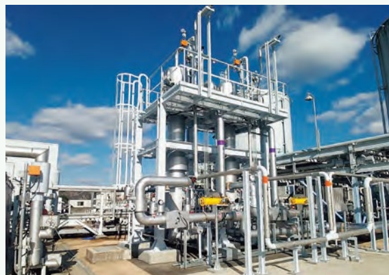
備後工場 LNG気化器
