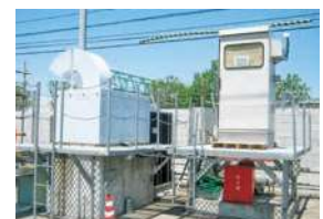
ガス差圧発電装置
