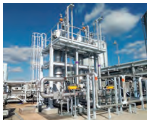
LNG vaporizer at the Bingo Plant
