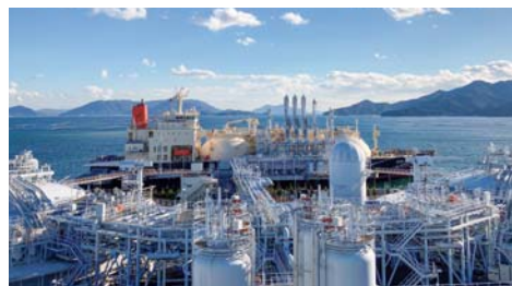
LNG ship docking at our Hatsukaichi LNG terminal
