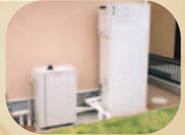
写真左が発電ユニット
