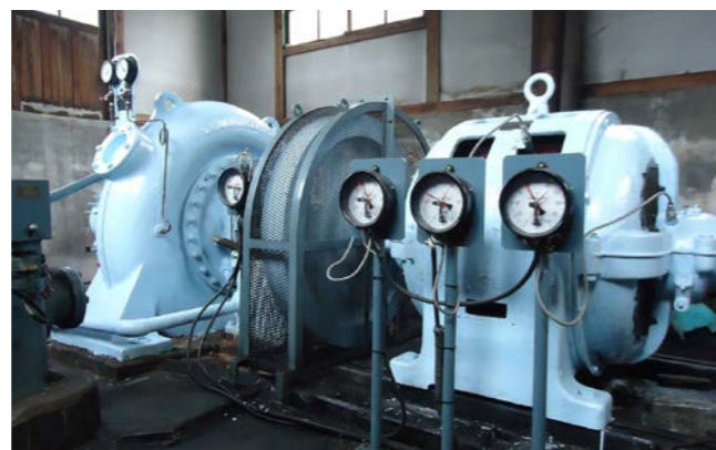
水車および発電機
