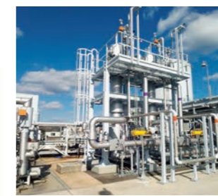
備後工場LNG気化器
