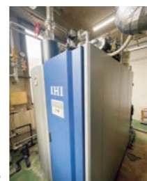
燃料転換した蒸気ボイラ
