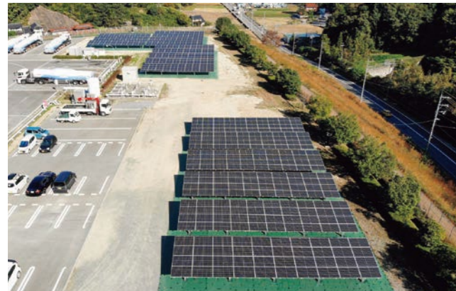
備後工場太陽光発電設備
