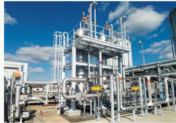
備後工場 LNG気化器
