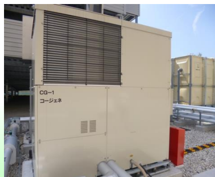
(工業用・業務用) ガスコージェネレーションシステム
