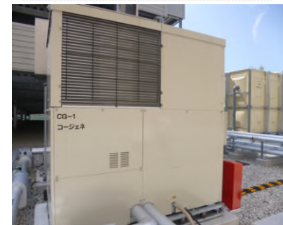
ガスコージェネレーションシステム
