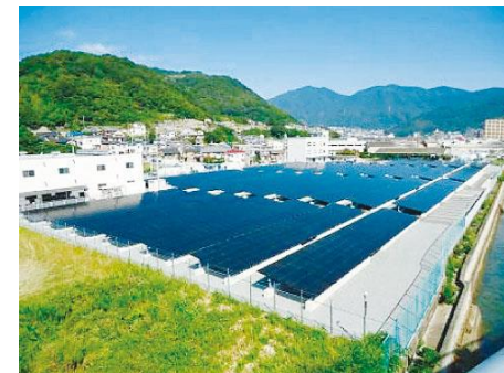
阿賀太陽光発電所(呉市)
