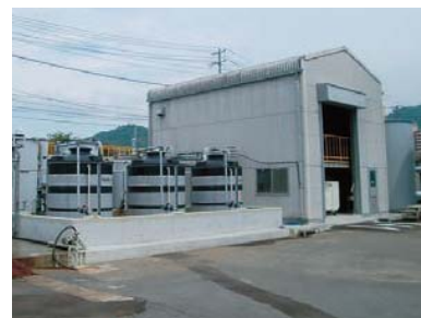
水処理装置(海田基地)
