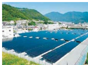
阿賀太陽光発電所(呉市)
