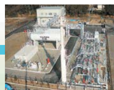
水島ステーション (瀬戸内パイプライン株式)
