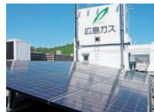
太陽光発電(尾道支店屋上)
