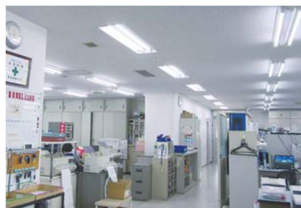
LED照明(本社ビル)
