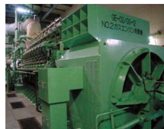
ガスコージェネレーションシステム(廿日市工場)
