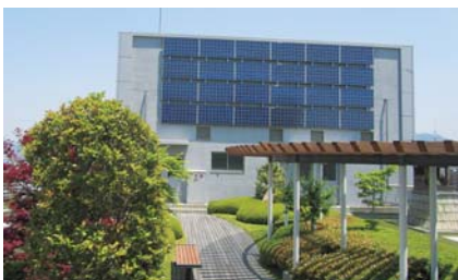
太陽光発電パネル(本社ビル屋上)
