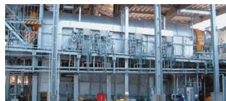
製紙汚泥の再資源化処理設備
