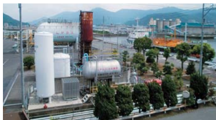
LPGタンカー窒素パージプラント
