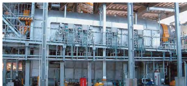
製紙汚泥の再資源化処理設備
