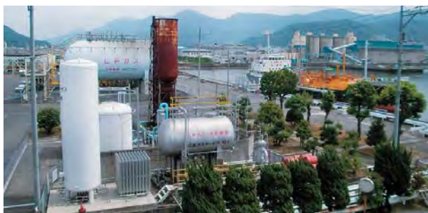
LPGタンカー窒素パージプラント
