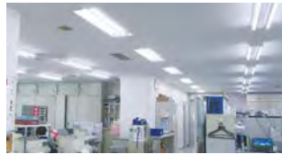
LED照明(本社ビル)
