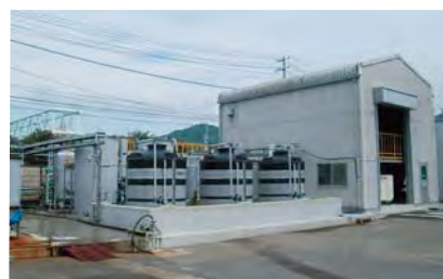
水処理装置(海田基地)
