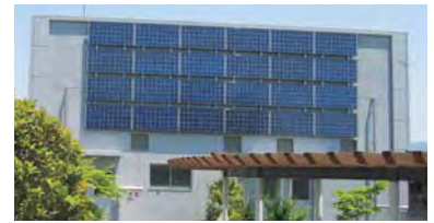
太陽光発電パネル(本社ビル屋上)
