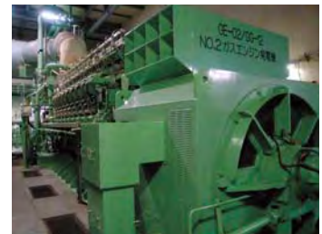
ガスコージェネレーションシステム(廿日市工場)
