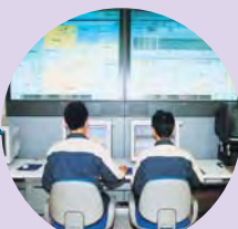
中央監視制御室
