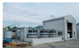
水処理装置 (旧海田工場跡地)
