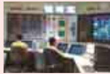
中央制御室での一括監視 (廿日市工場)
