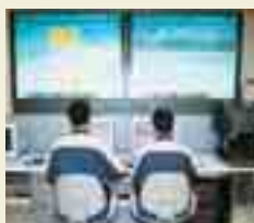
中央監視制御室(本社)
