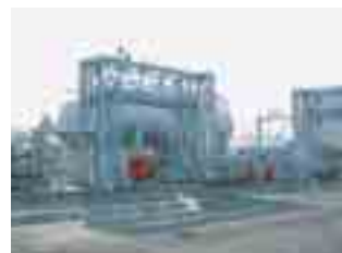
水島ステーション(瀬戸内パイプライン(株))
